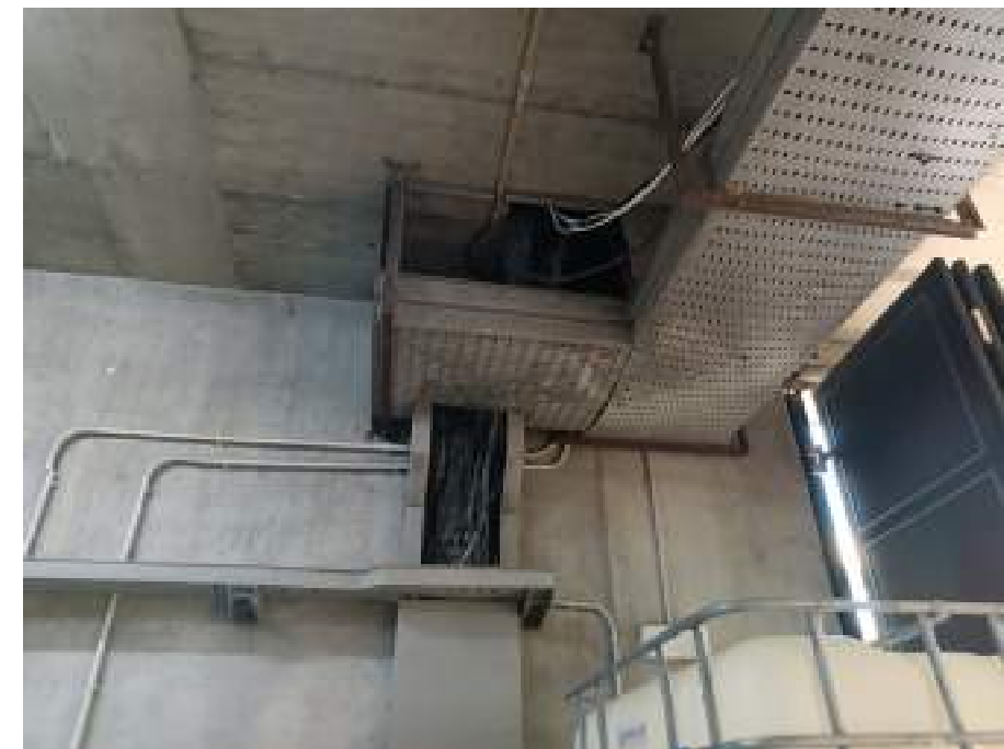
Figura 29. Safata elèctrica existent de baixada cap a planta d'espessors
