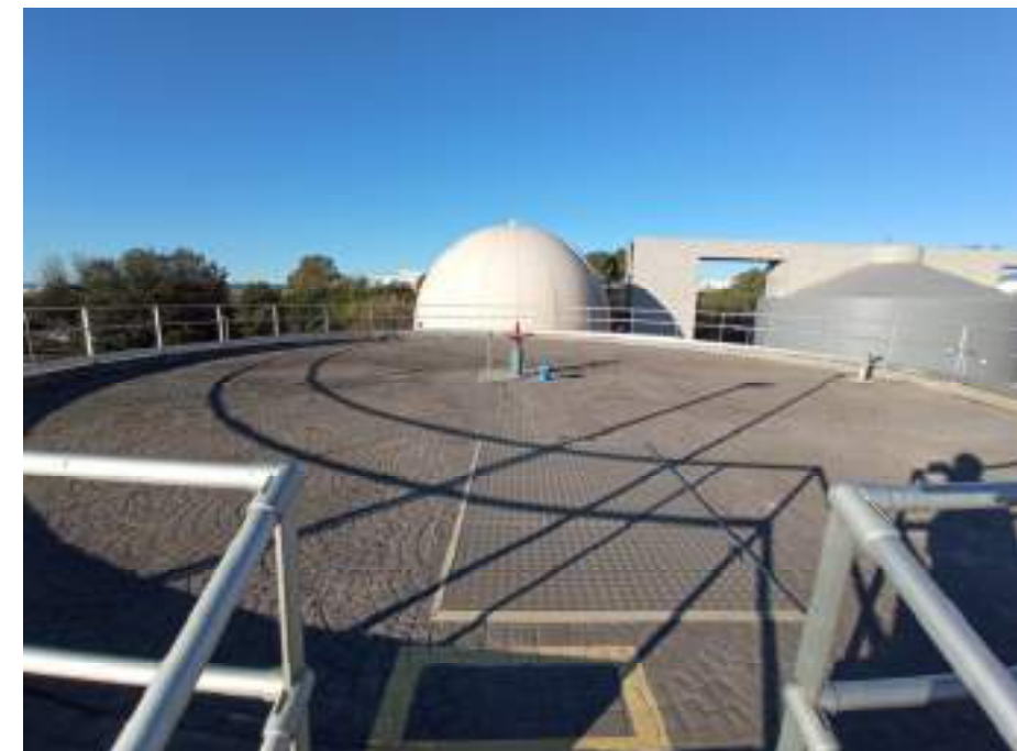
Figura 5. Estat actual de la coberta del espessor
