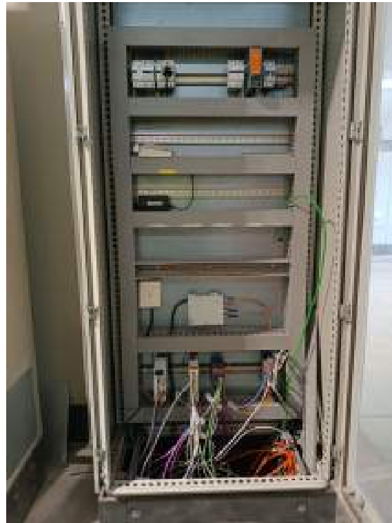
Figura 26. Armari de comunicació ETHERNET del recinte CCM1-CCM3
