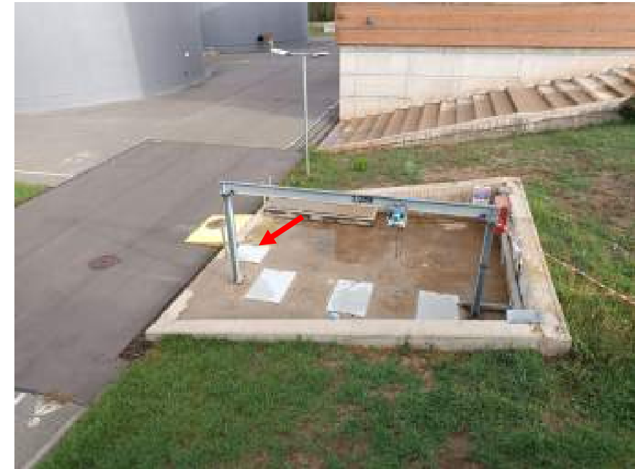
Figura 16. Connexió a la línia de drenatges de la planta
