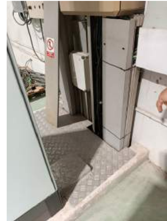
Figura 28. Pas d'instal·lacions elèctriques cap a planta d'espessors mecànics
