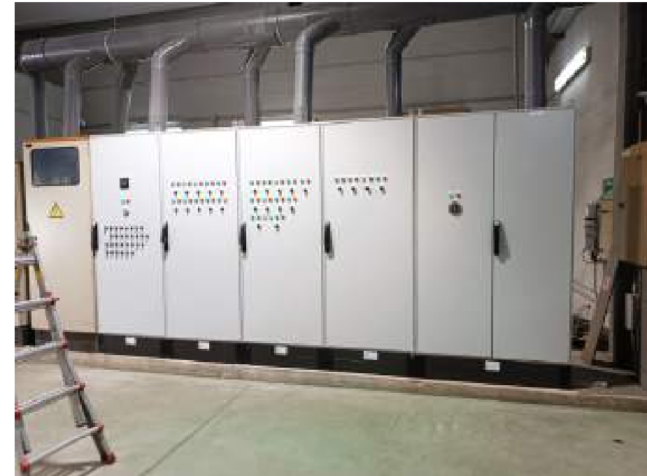
Figura 24. Interior recinte CCM1-CCM3
